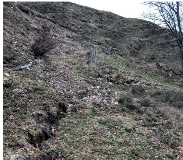
Abrutschkante bei der Quellfassung
